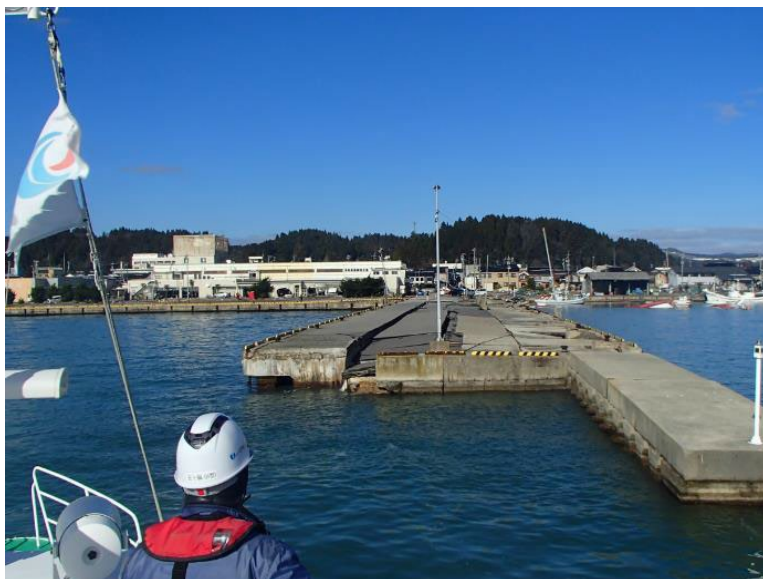
地震発生翌日から災害復旧に向けた被災状況調査を実施
