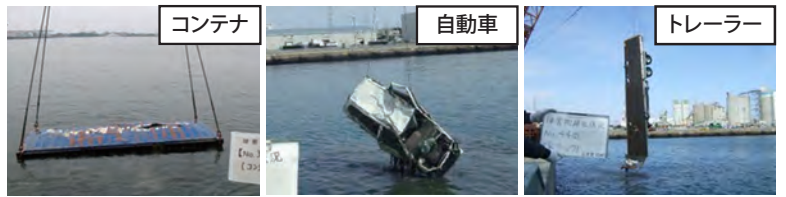
東日本大震災地震津波による漂流物の撤去作業(仙台塩釜港)
