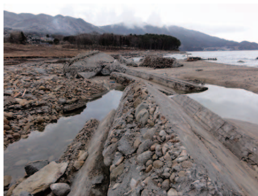
洗掘により倒壊した海岸堤防(南三陸町)
