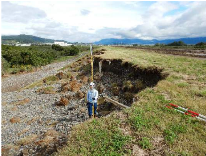
堤防被災状況調査
