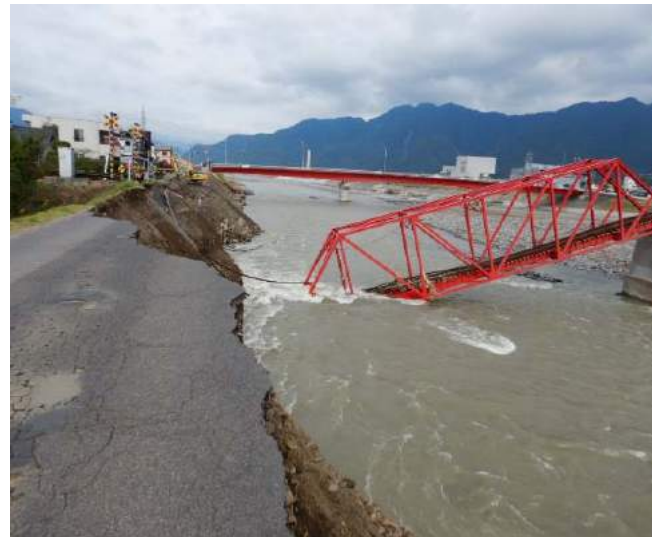
千曲川堤防欠損（左岸104k付近）
