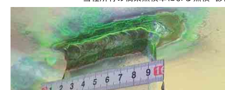
鋼桁亀裂損傷の詳細調査
